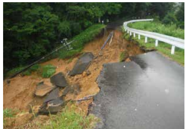
堤防が崩落した冠光寺池 (岡山市広報広聴課提供)
