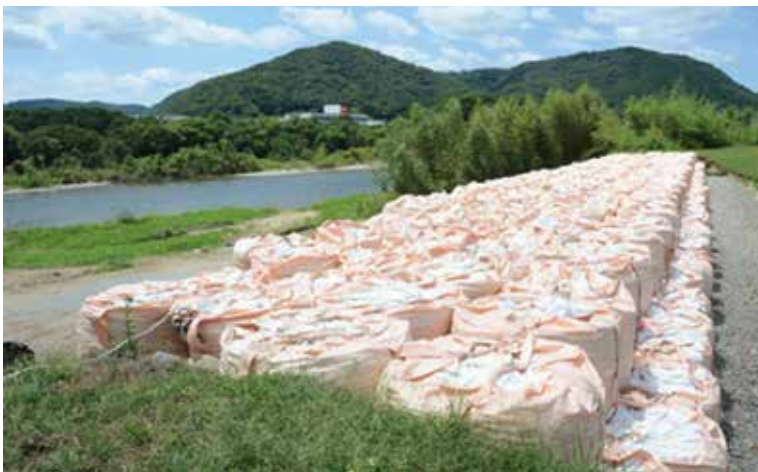
50メートルにわたって旭川の堤防が崩落した現場＝北区御津国ヶ原 （山陽新聞社提供）
